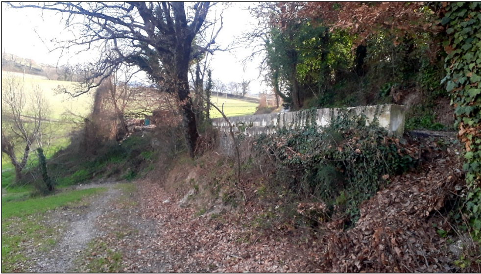
Frana F-12-1508: muro di contenimento della scarpata stradale in dissesto
