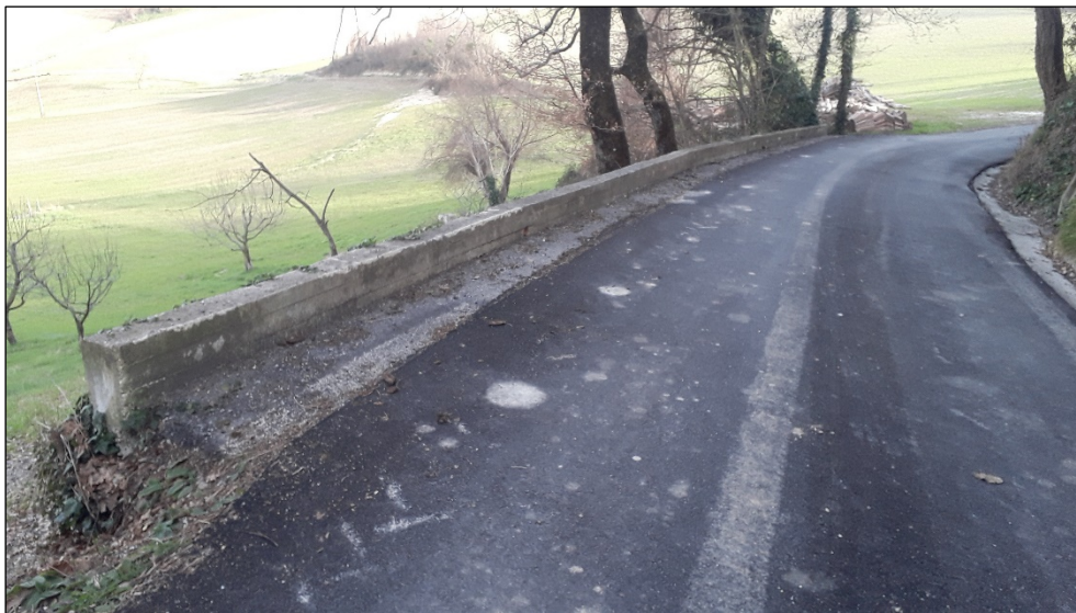
Frana F-12-1508: muro di contenimento della scarpata stradale
